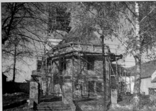
Kostel v Želči čekají rozsáhlé opravy.
